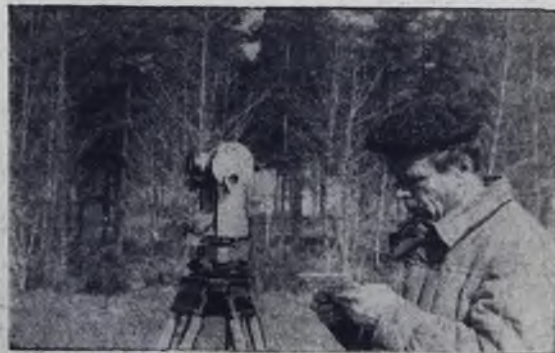
Дружно работали на Всесоюзном субботнике ангарские строители. В этот день геодесты Василий Сысов, Валентин Шерда, Владимир Галуза, Николай Феоктистов провели работы на месте, где будет строиться детский искусственный коток.
