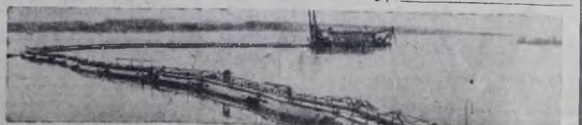
ЧЕБОКСАРЫ. Начал работы на строительстве пос. Зайначим земснаряд. Идет намыв грунта для переезда ГЭС. Сейчас в районе Ново-Чебоксарска, на Волге за-... Фото В. Войтенко.
