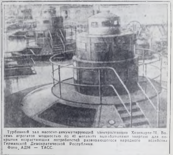
Турбинный зал насосно-аккумулирующей электростанции Хэиньцунь-II. Восемь агрегатов мощностью по 40 мегаватт вырабатывают энергию для покрытия возрастающих потребностей развивающегося народного хозяйства Германской Демократической Республики. Фото, АДН — ТАСС.
