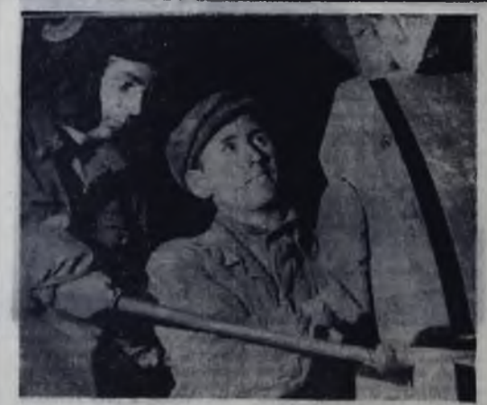
Ускоренными темпами идет ремонт второй печи обжига на Ангарском цементном заводе. Среди тех, кто сегодня по-ударному трудится на ремонте печи, слесари Станислав Евстратов и Михаил Федоров.
