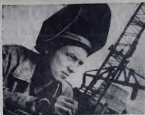
Напряженно в эти дни работает бригада Г. Ф. Ежова на сооружении ГФУ. На снимке вы видите одного из самых молодых членов этой бригады электросварщика Алексея Зеленова. Фото В. Небогина.
