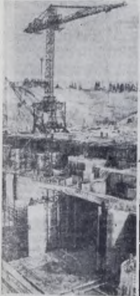
Латвийская ССР. С каждым днем ширится фронт работ на строительстве Плявиньской ГЭС на реке Даугаве. Это будет крупнейшая гидроэлектростанция в Прибалтике. Первая очередь ее вступит в строй в 1964 году. На снимке: общий вид строительства Плявиньской ГЭС. Фотохроника ТАСС.
