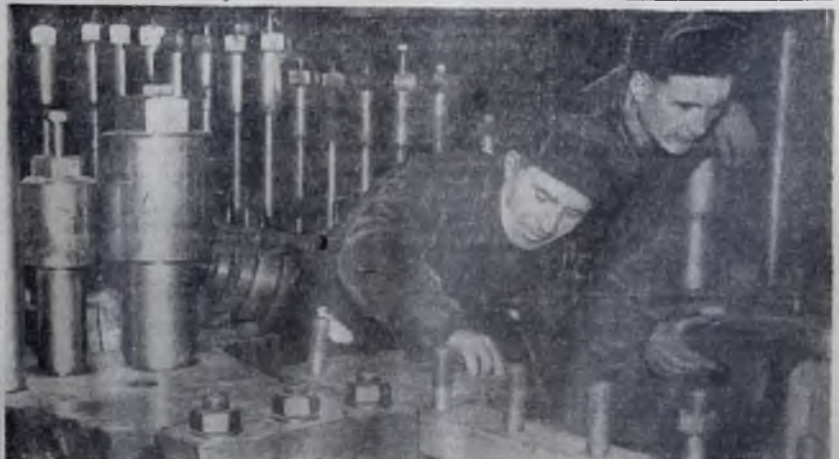
Горячая пора сейчас у монтажников Востокэнергомонтажа — нужно досрочно смонтировать очередную очередь турбины. Эту сложную работу выполняет бригада коммунистического труда слесарей-сборщиков Владимира Соловьева. Особенно хорошо трудятся Андрей Кадыков (слева) и Александр Пантелеев, которых вы видите на нашем снимке.
