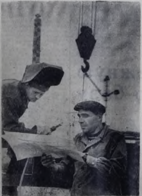
Высокими темпами ведется сборка каркаса котла № 1 на ТЭЦ НПЗ. Эту ответственную работу выполняет бригада из «Востокэнергомонтажа», руководимая опытным бригадиром Михаилом Александровичем Цариком.
