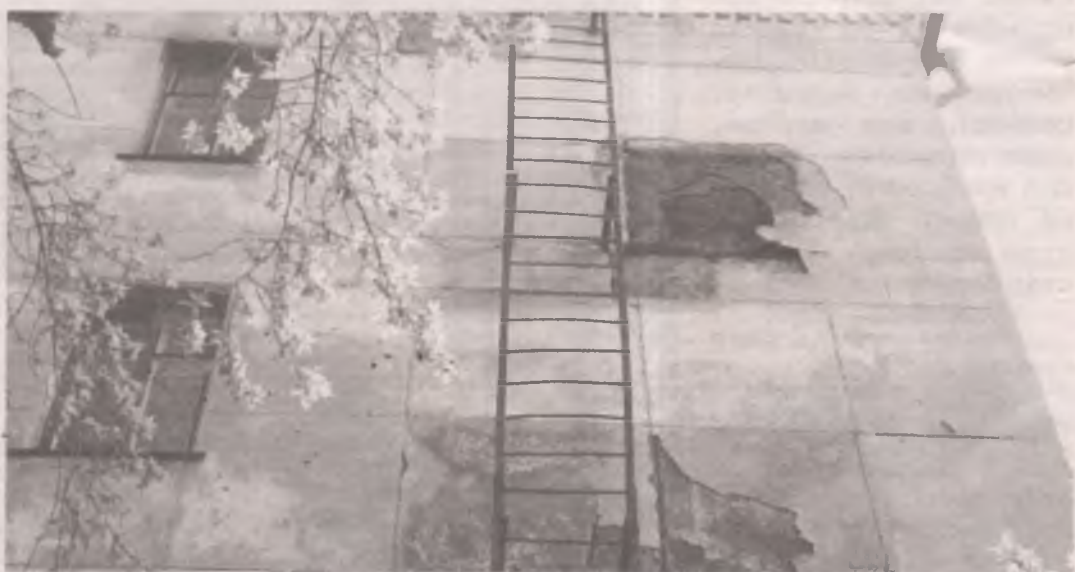
■ Разрушение наружной стены, которое усугубилось после череды землетрясений. Строители считают, что это вполне поддаётся ремонту.
