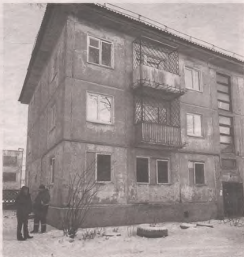
■ Невооружённым взглядом эксперты обнаружили на здании повреждения, следы коррозии, трещины.
