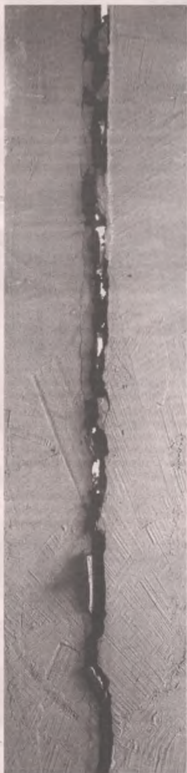
■ Дом начинается с тамбура. Второй подъезд этого дома начинается с трещины в тамбуре.
