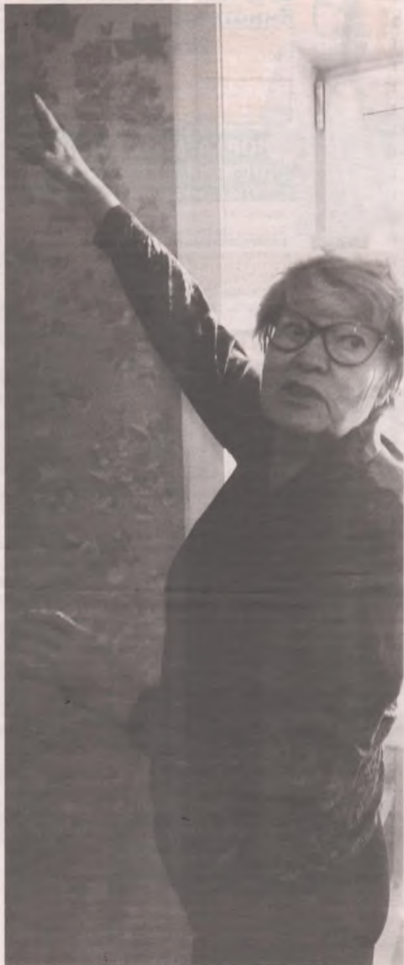
■ Любовь Яковлевна САВЕЛЬЕВА: «Главная трещина дома, которая проходит по стене моей квартиры, со временем стабилизировалась и угрозы не представляет».
