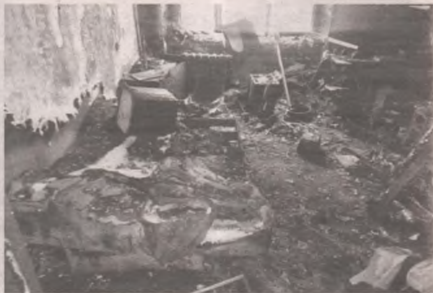
Комната выгорела полностью.
