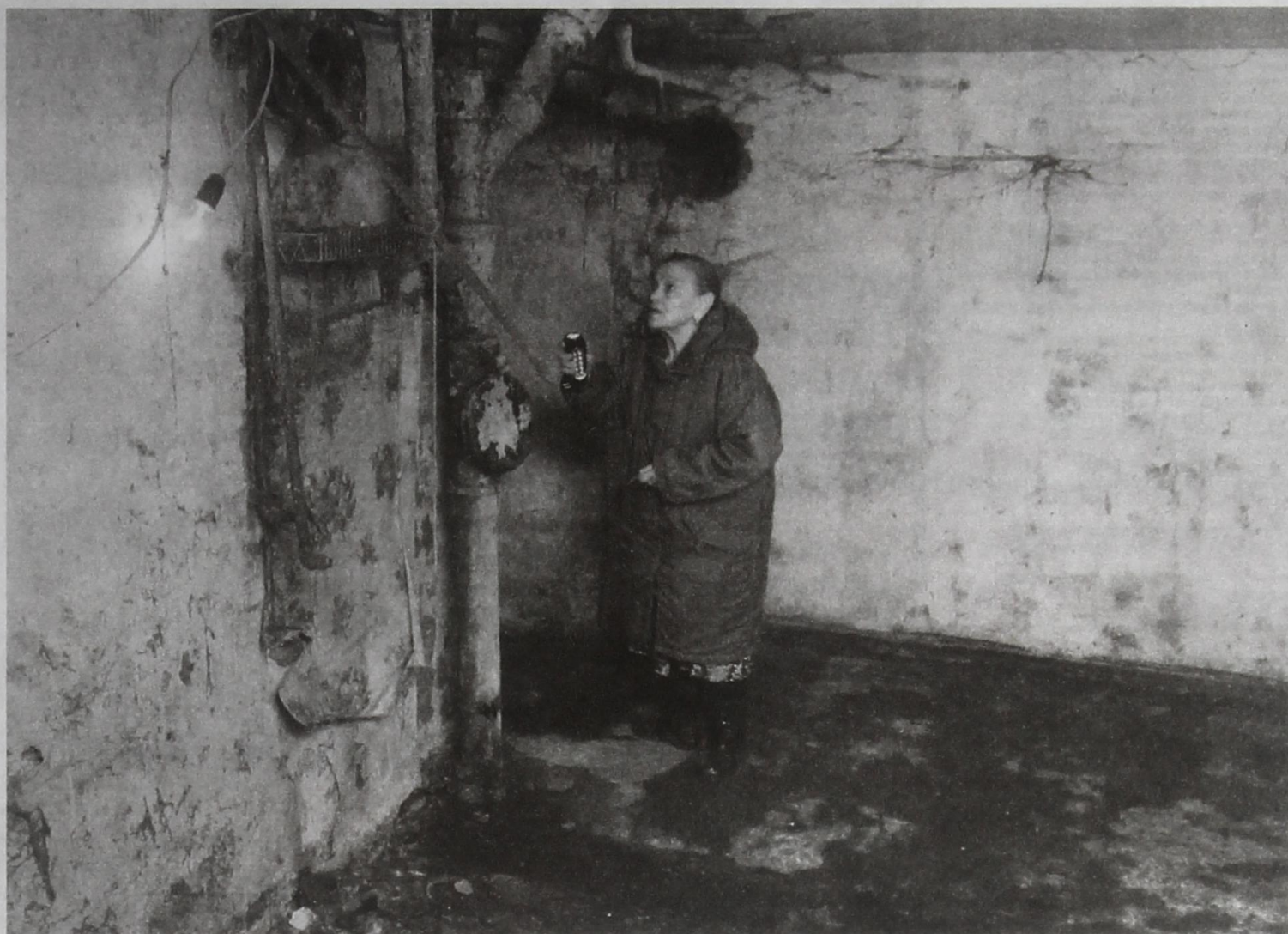
■ Сейчас в подвале-убежище дома № 5 пусто. Но из-за нарушенной вентиляции довольно влажно. Это и беспокоит жильцов, ведь в квартирах начал появляться грибок.
