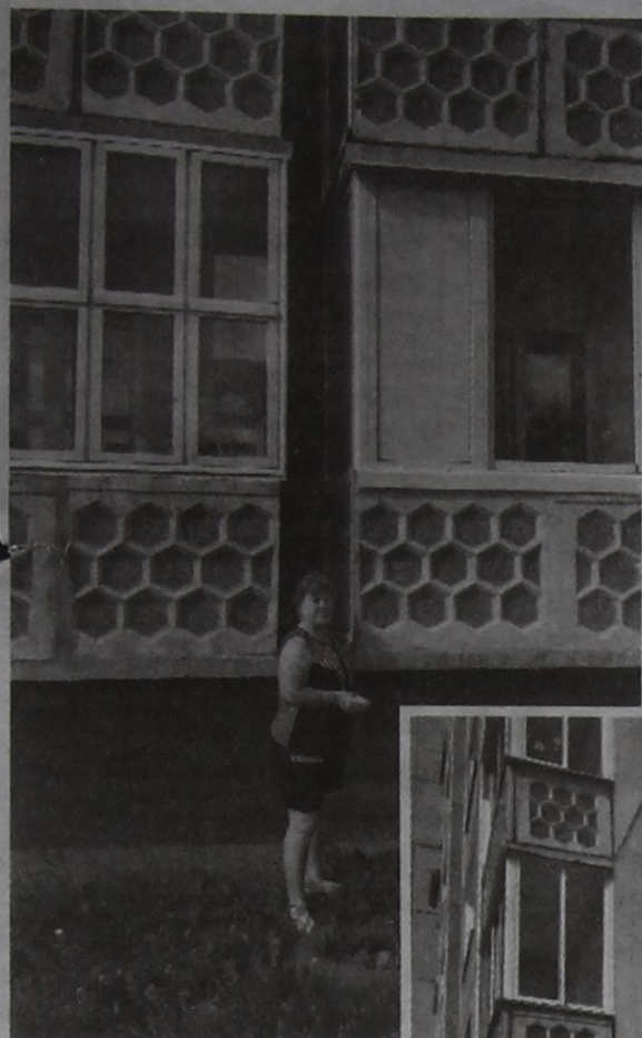
■ Эти стыковочные швы между балконами будут утеплены и заделаны.
