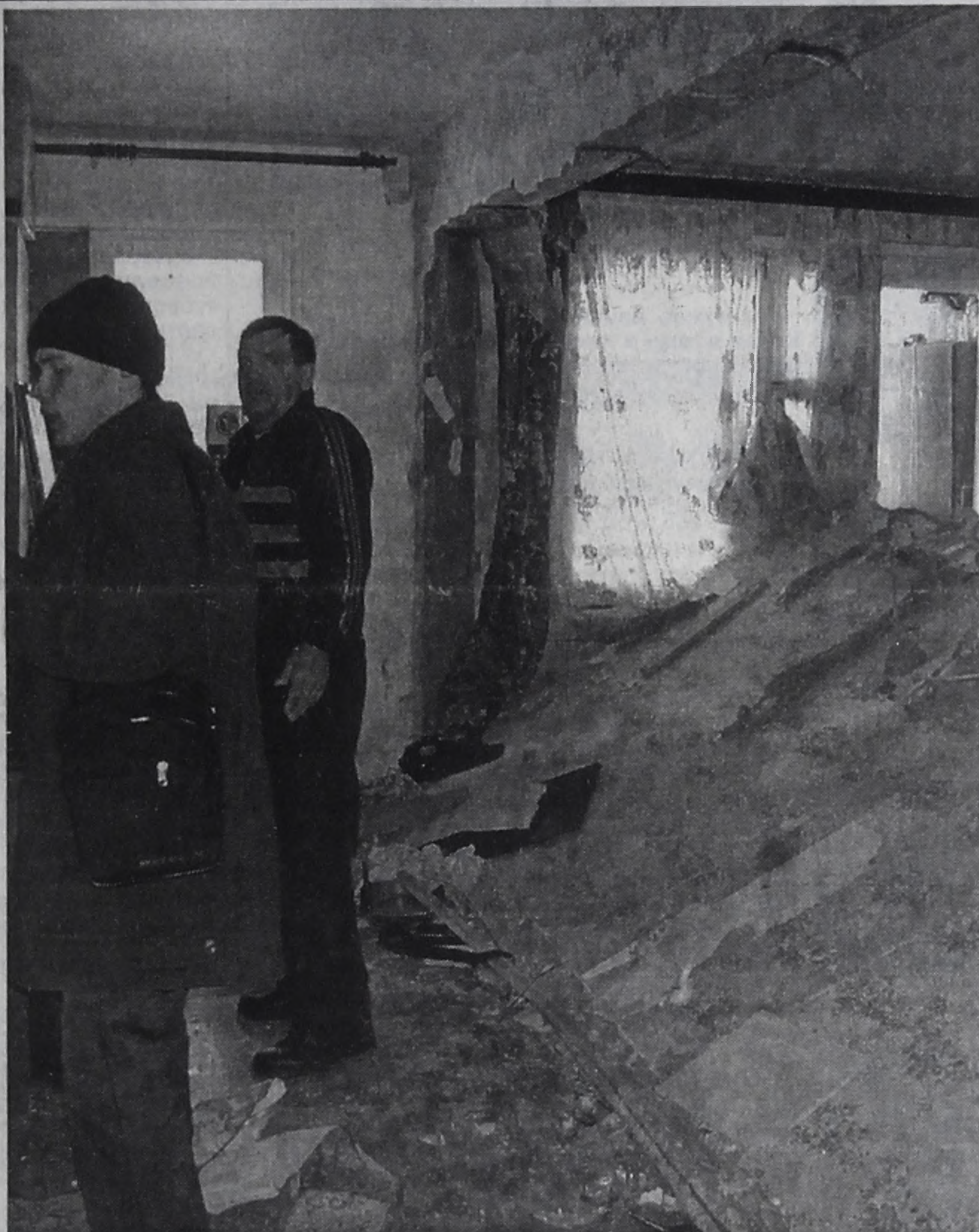
32 мрн, дом 4. 1 апреля 2004 г.: под этой стеной находится диван соседки пострадавшей.
