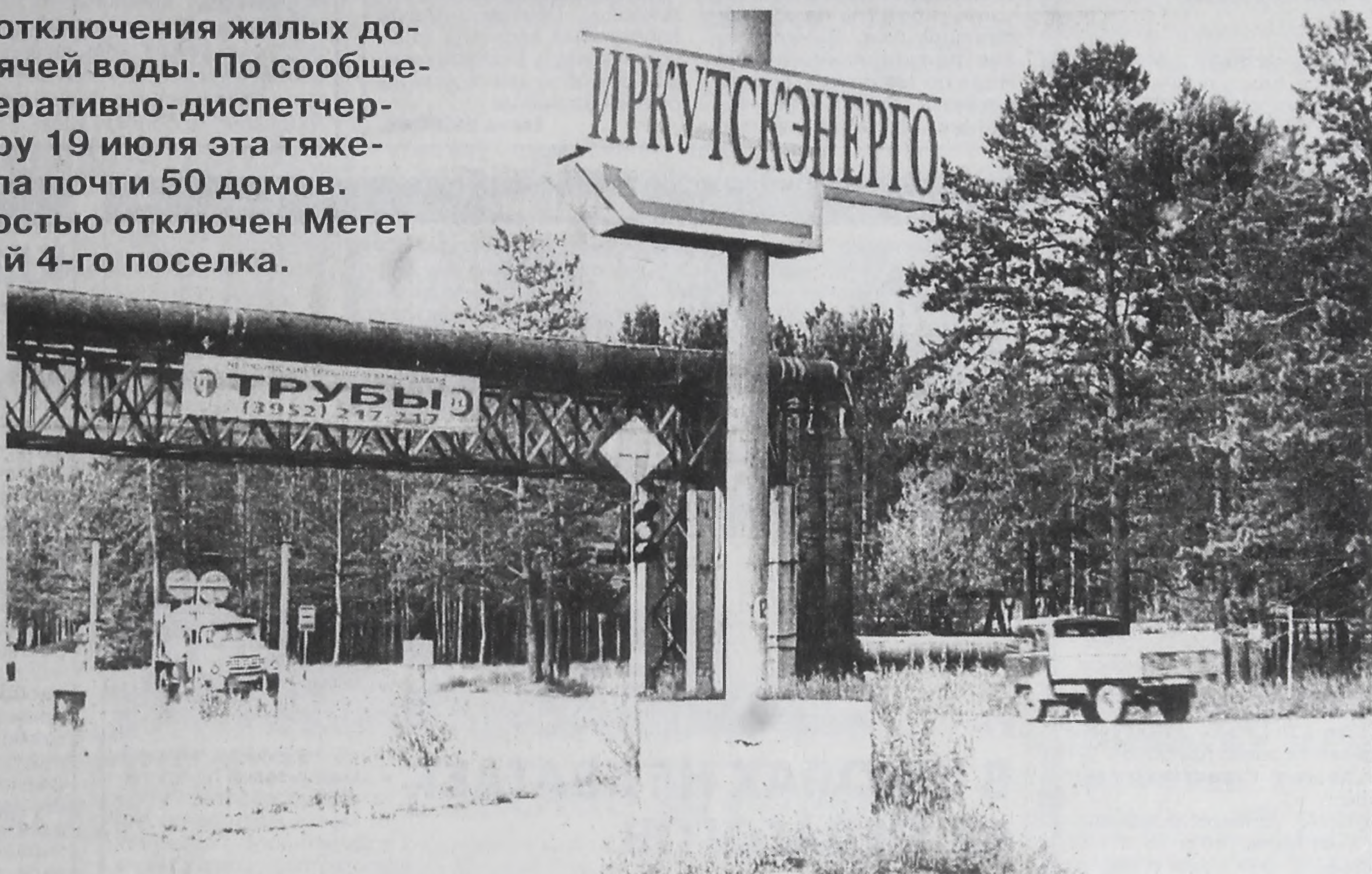
Оголенные тепломагистрали отапливают космос. Процесс вынуждены "спонсировать" горожане.
