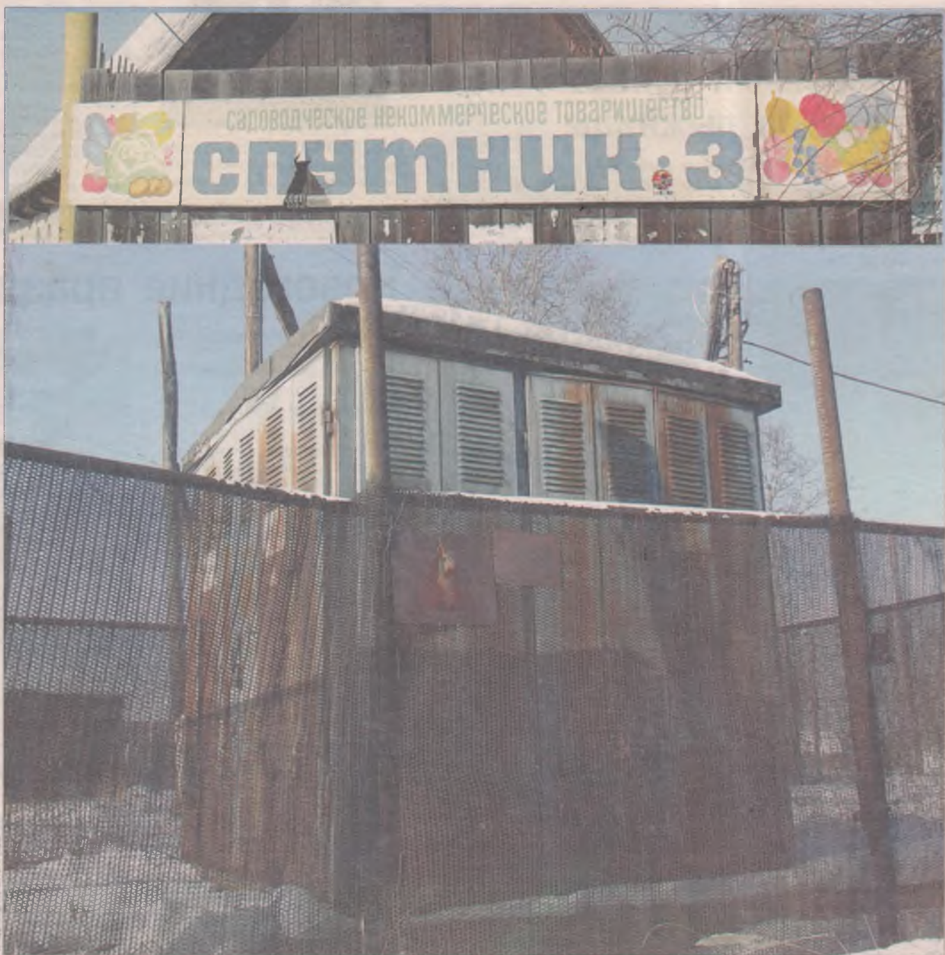
Именно этот трансформатор обеспечивает электроэнергией четыре городских садоводства
