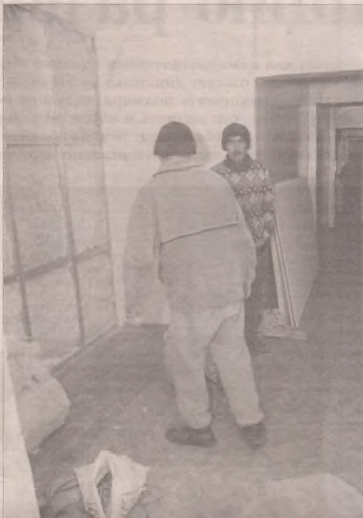
Вот так в МЖК-2 возводятся подъездные стены. Интересно, какой проектировщик их проектировал и какие инстанции разрешили делить подъезд обычным куском гипсокартона?! А если пожар?
