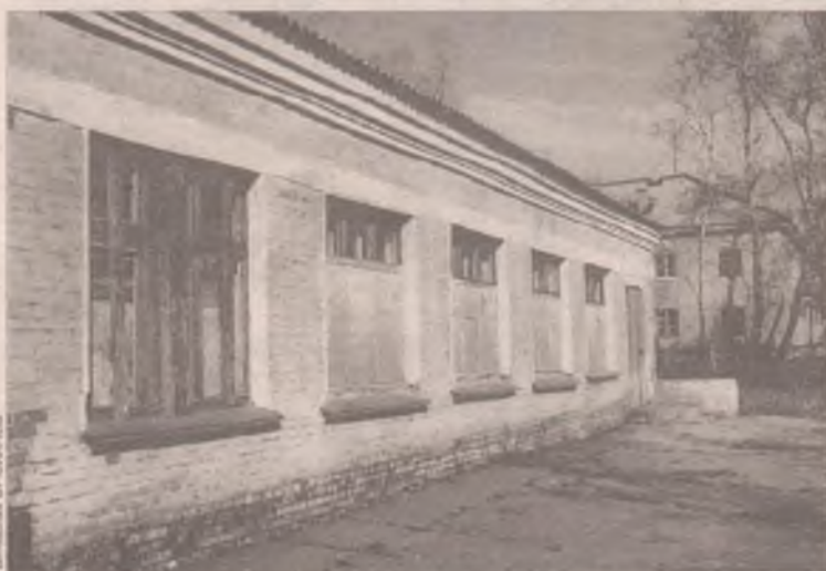
В это аварийное здание с окнами, забитыми «дровами», две администрации хотят одновременно поселить и кружки «Дружки», и библиотеку. А вот кто будет ремонтировать новый «очаг культуры» с забитыми окнами в поле - неясно...
