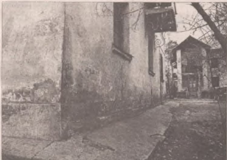
Жить в доме, где разваливается фундамент, а по стенам идут трещины - значит ежедневно ждать беды
