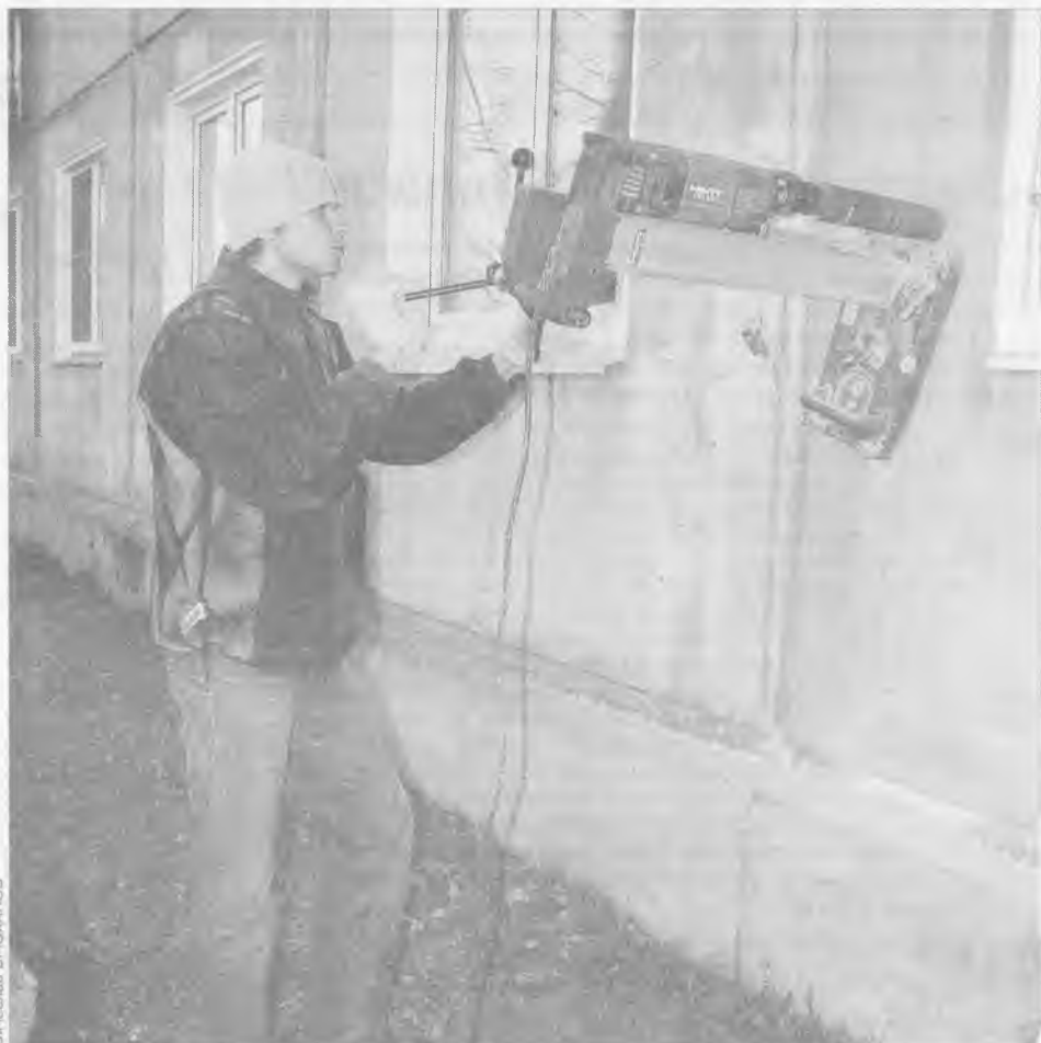
В домах серии 135с (хрущевках) арматура подвергается коррозии, и они начинают деградировать
