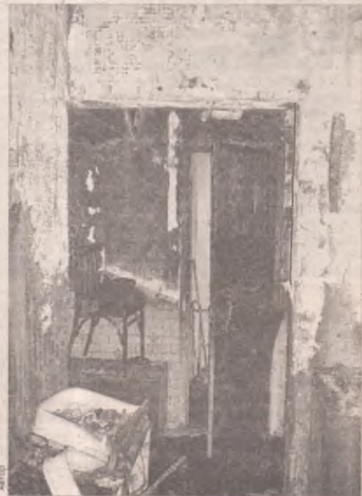
Причина беды - неисправная проводка
