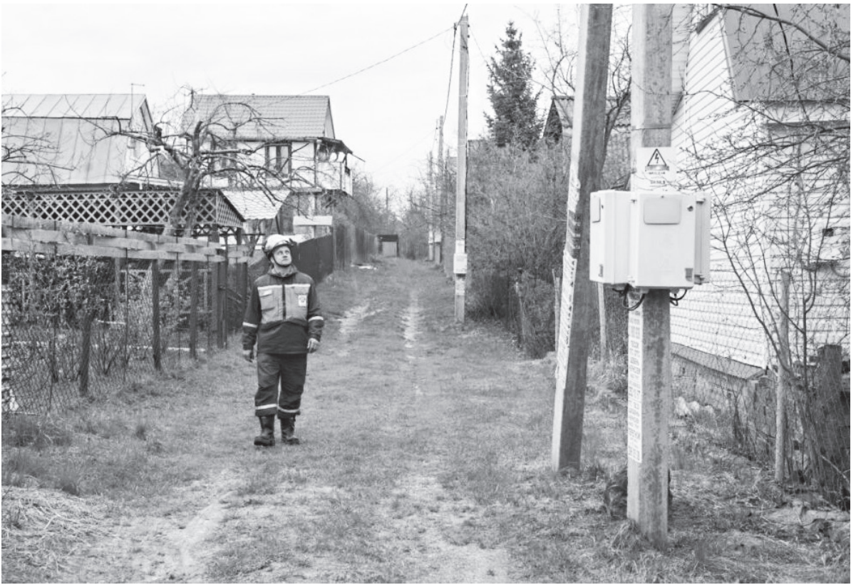
■ Во внутренний тариф каждого СНТ включены тариф на электроэнергию, утверждённый в Иркутской области, содержание внутренних сетей, а также расходы на освещение улиц, работу насосного оборудования и потери на линии
