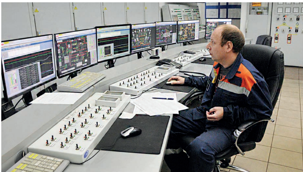
■ Первый энергоблок «десятки» был пущен в 1959 году. Оборудование того времени ещё встречается в операторных, но постепенно его заменяет современная аппаратура
