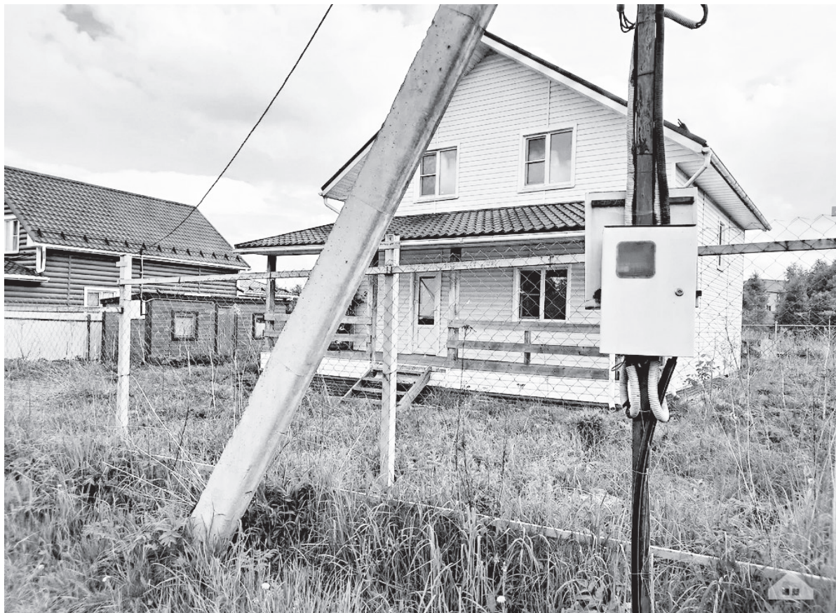
■ Линии электропередач должны обслуживать профессионалы. Сейчас появилась реальная возможность передать специализированной организации существующую систему электроснабжения, включая внутренние сети садоводств в районе Подсочки
