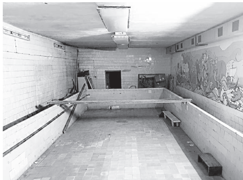
■ Малая чаша находится в аварийном состоянии и восстановлению не подлежит. Пристрой, в прямом смысле слова, разваливается. Вариант один - сносить его и строить новый бассейн для малышей
