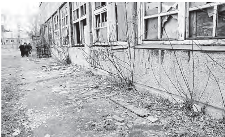
■ Первые демонтажные работы вандалы уже провели. Теперь ориентировочная стоимость восстановления бывшего училища №8 - 250 млн рублей
