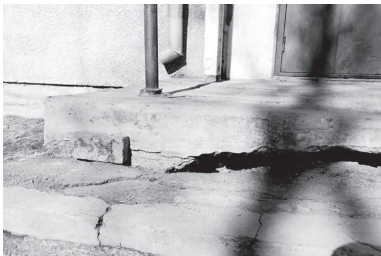
Вот так выглядело крыльцо до ремонта
