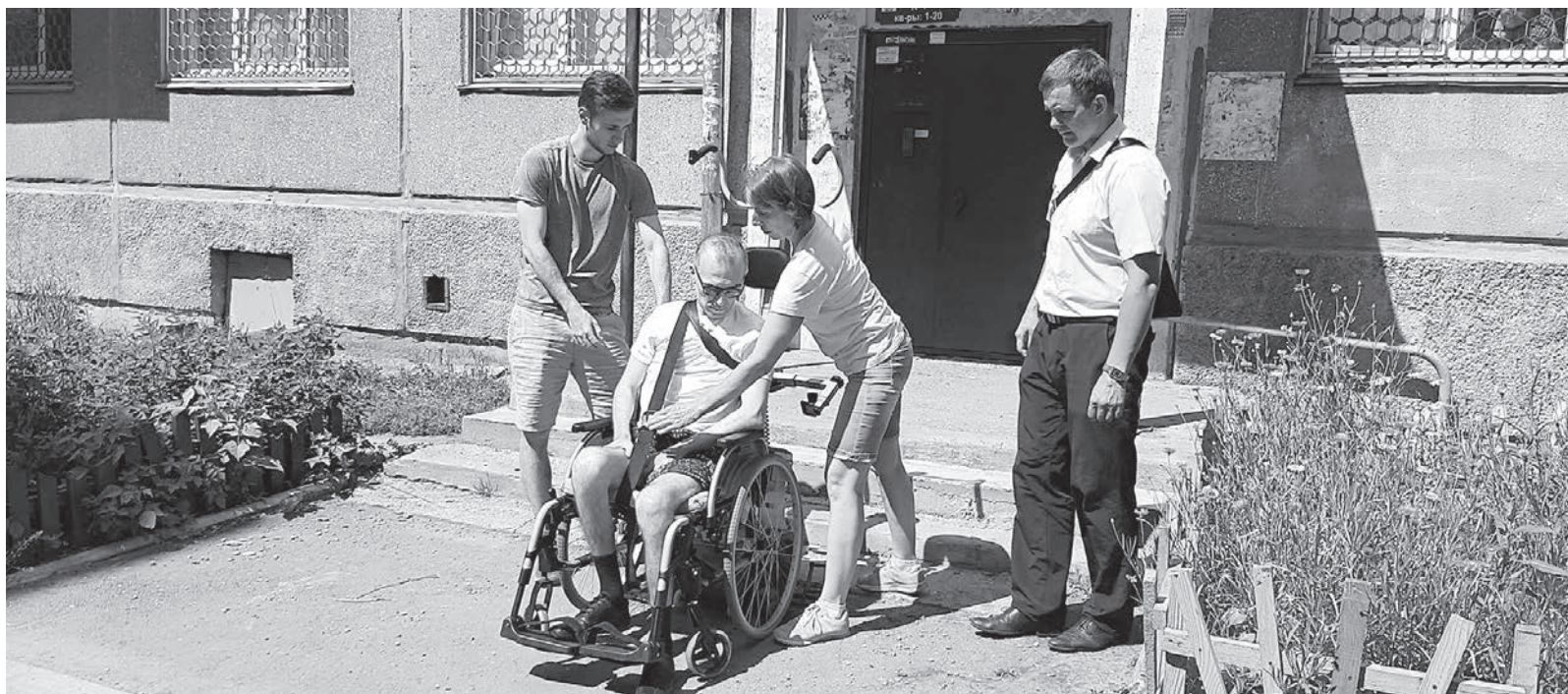
Когда Ольга покупала квартиру, она не обратила особого внимания на то, что крыльцо перед подъездом в аварийном состоянии. Главным для неё было сделать такой ремонт в квартире, чтобы Дмитрию было удобно передвигаться на коляске. Для спуска по ступенькам Ольга вместе с сыном купили специальное устройство – лестничеход. Однако пользоваться им они не могли целый год...
