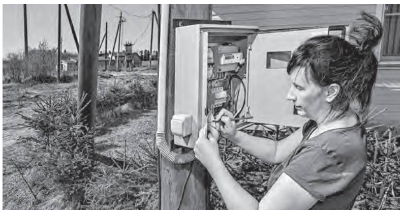
После того, как на каждом участке установили электросчётчики, собираемость оплаты за электроэнергию увеличилась
