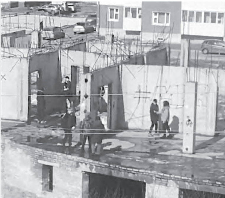
Строительство жилого дома в 32 микрорайоне не ведётся с августа 2009 года. Пока собственник объекта игнорирует предписание суда, по развалинам бегают дети
