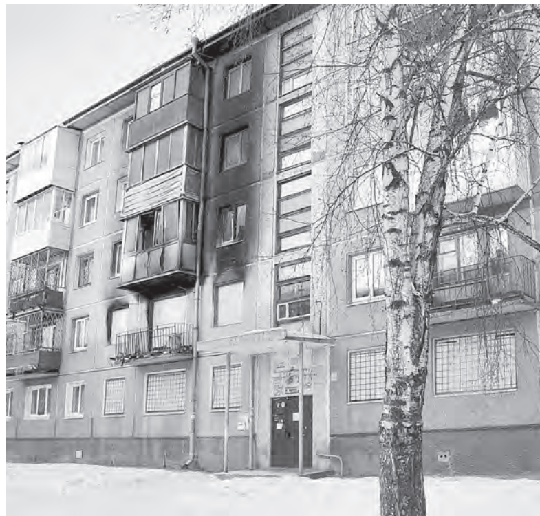
После подписания постановления о предоставлении материальной поддержки режим ЧС в Ангарском округе был снят. Жители могут ходить по агентствам и подбирать новую квартиру, властям предстоит решить вопрос с демонтажем пострадавшей конструкции
