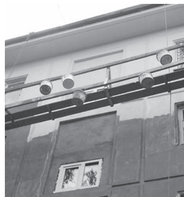
В 211 квартале техническое обследование дома было проведено без жителей. В итоге плесень и грибок были просто покрашены фасадной краской, а крыша как бежала, так и бежит
