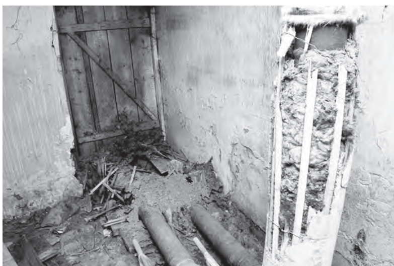
Бывает, что с устранением последствий проведённых капремонтов жителям приходится бороться годами. Зачастую устранить брак подрядчиков не может заставить даже заказчик работ - Фонд капремонта Иркутской области
