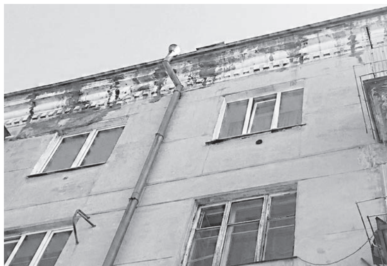
В доме 1 в 211 квартале специалисты фонда приняли решение провести только ремонт фасада, а кровлю не трогать. Плесень и грибок на верхних этажах были просто покрашены фасадной краской, а крыша как бежала, так и бежит
