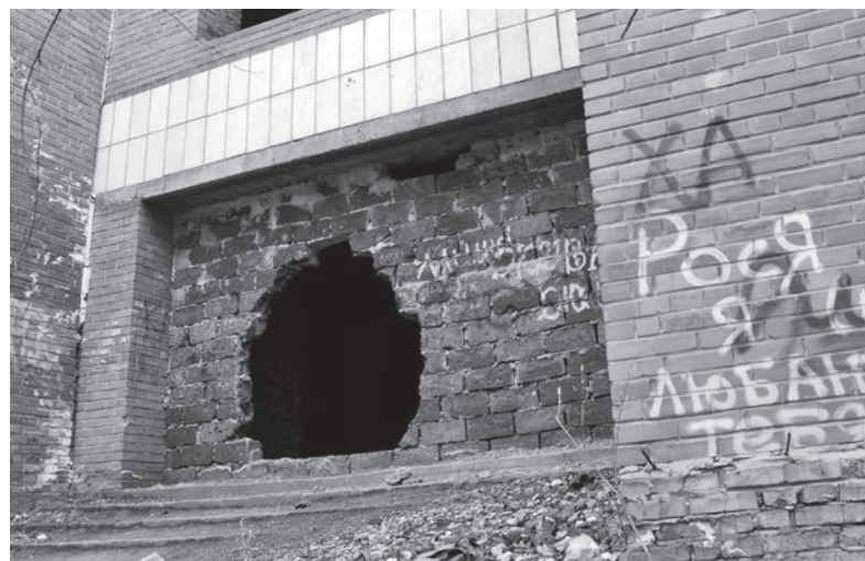
Кладку из строительных блоков в дверях и окнах разобрали, и через проломы подростки проникали внутрь
