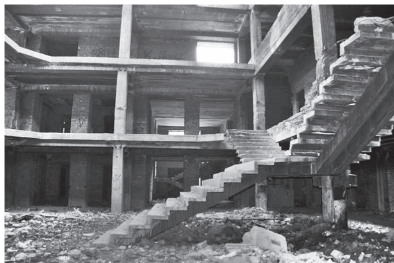
Конструкции внутри здания - лестницы, площадки, перила - проржавели и обваливаются
