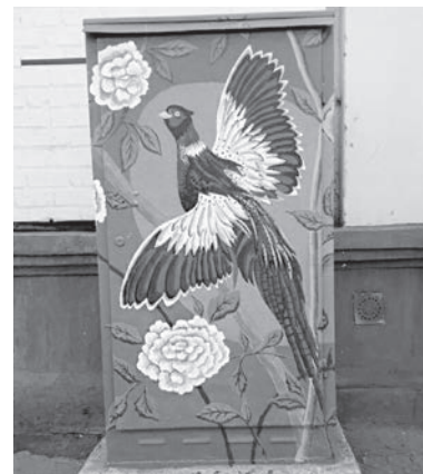
А так выглядит электрощит в Челябинске после работы художника
