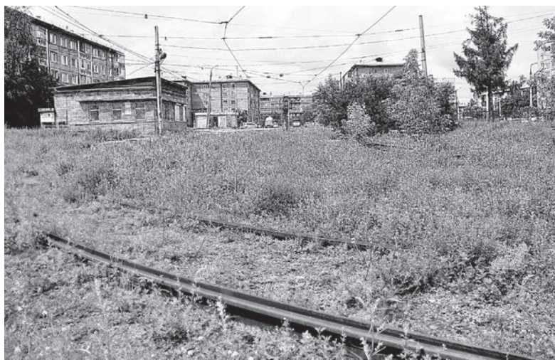
Специалисты обследовали ветку и пришли к выводу, что возможность отремонтировать конструкцию есть, начали искать детали и считать, в какую сумму предприятию обойдутся восстановительные работы
