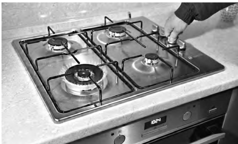
Есть плиты, которые не проверяли по пять-шесть лет. В каком состоянии находится внутриквартирная сеть, специалисты не знают
