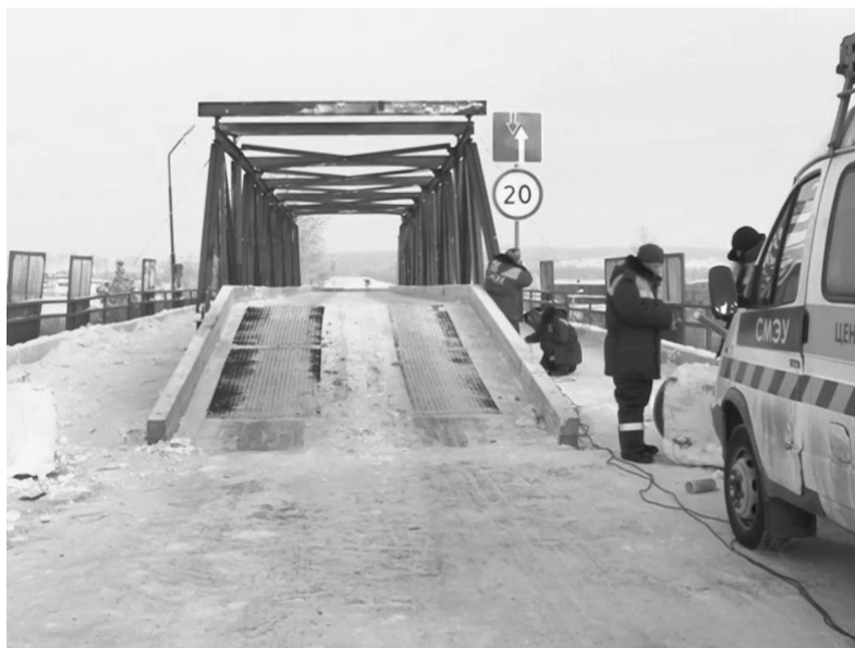
На виадук поставили ещё один мост, который исключил нагрузку на разрушенную опору
