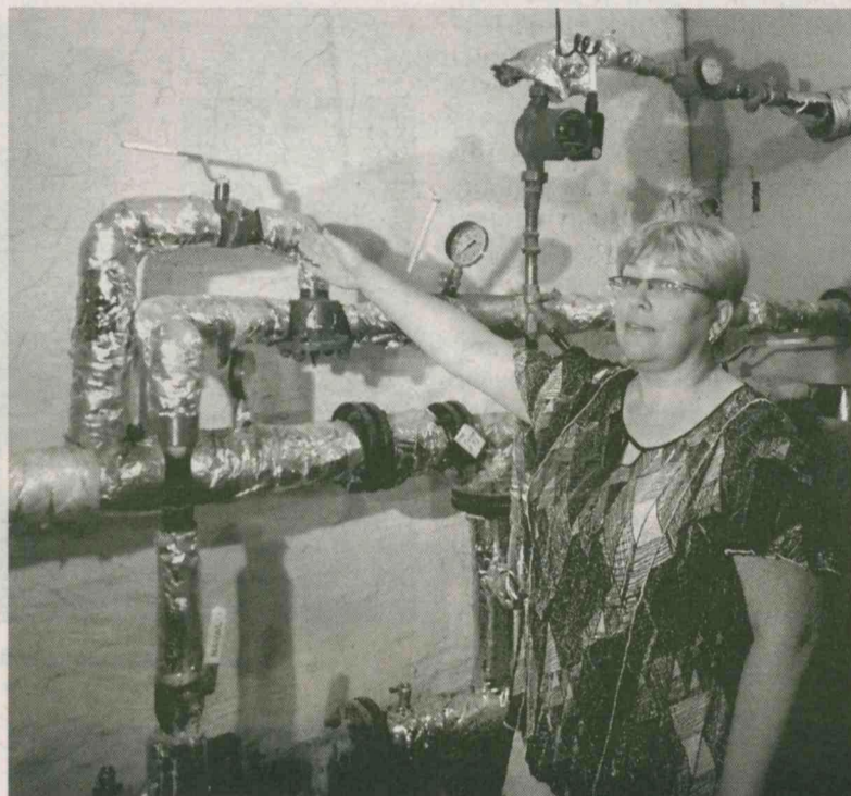
18 микрорайон, теплоузел в доме 1. Чтобы экономить тепло, нужна наладка систем отопления и регулировка температуры подачи энергии в тепловом пункте
