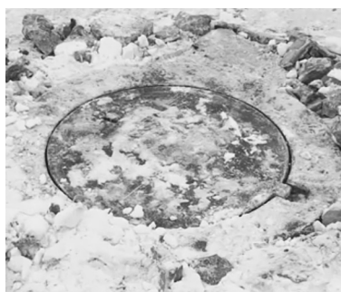
Сейчас крышка люка чудесным образом забетонировалась.
