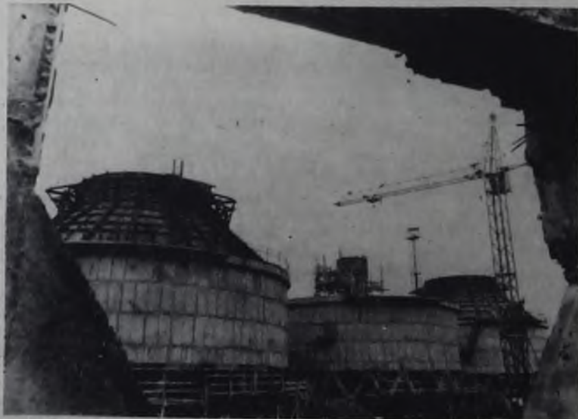
На снимке: градирни важнейшего пускового комплекса этилен-пропилен-300.
