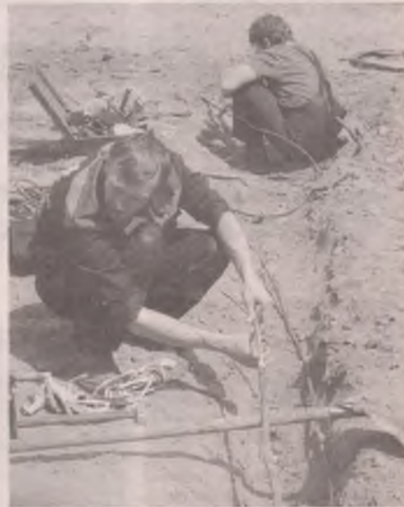
Около школы №27 подрядчики так рьяно «обдирали» дорогу, что повредили электрокабель, оставив без света целый район. Восстанавливать электричество пришлось сотрудникам «Облкоммунэнерго».
