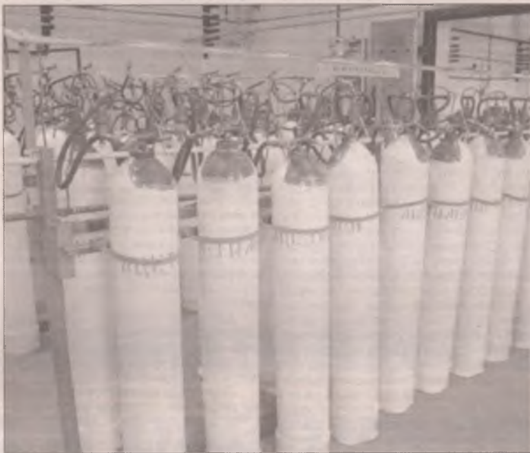
19 февраля 1999 года пущена в строй новая ацетиленовая станция. Продукция в баллонах расходуется за два часа – так велик спрос на ацетилен. Эта станция единственная в регионе от Новосибирска до Дальнего Востока.
