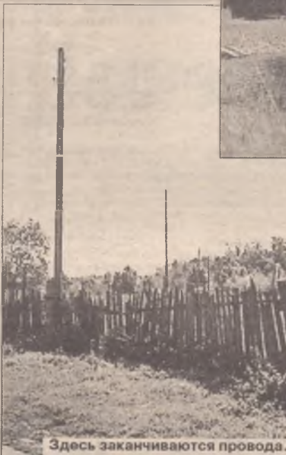
Здесь заканчиваются провода.
